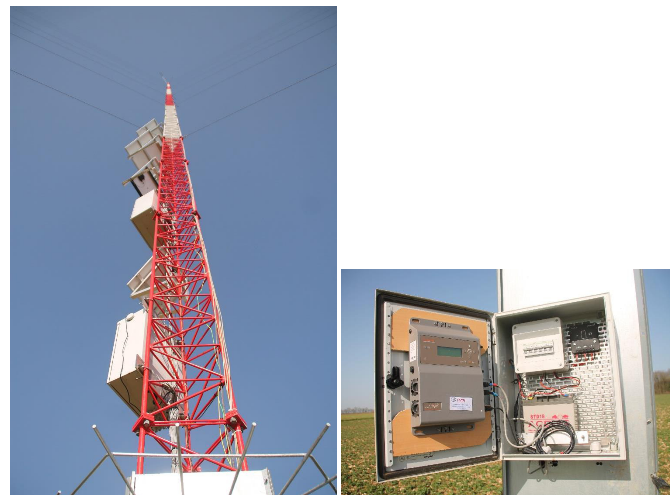
Figure 16 : Installation du mât de mesure et du matériel d'enregistrement (SM3BAT) ©NCA Environnement
